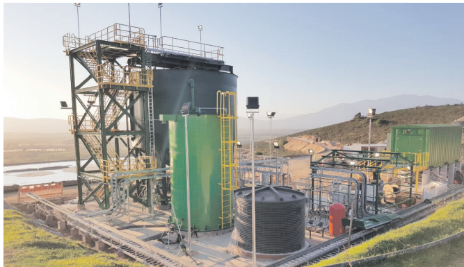
La planta de espesado de Compañía Minera Pullalli permite la recuperación y circulación del 80% del agua al proceso.
